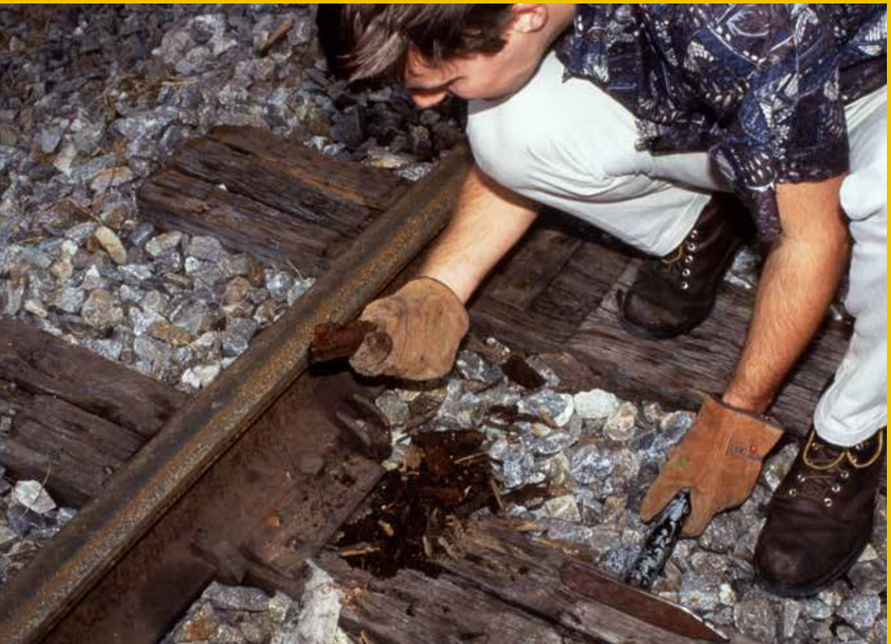
נזק ע"י טרמיט-העל הפורמוסי לאדני עץ של מסילת רכבת שעברו טיפול בחומר מגן המופק מזפת
